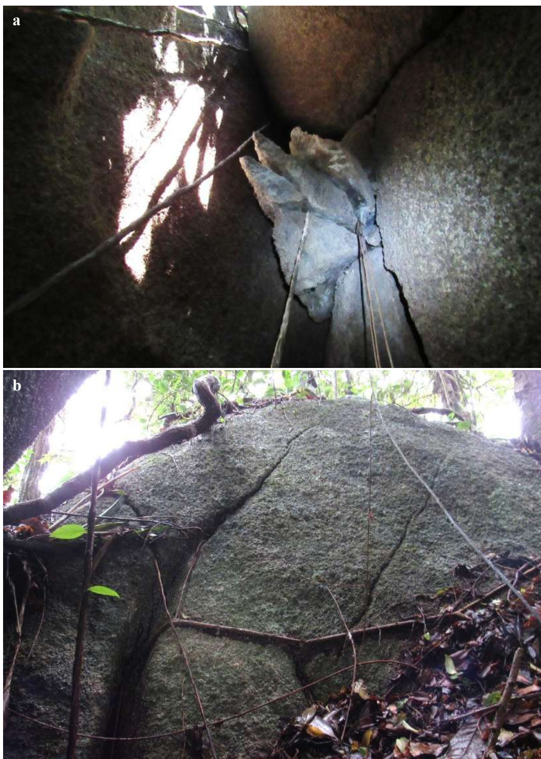
Figura 5.29 – Raízes crescendo ao longo de fraturas, com colaboração no processo de ampliação das aberturas, fragmentação dos matacões e formação de descontinuidades secundárias: a) teto da cavidade; b) matacão junto a uma das entradas do SAC.
